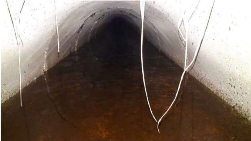
Foto 5. Vaade truupi T6 sissevoolu poolt. Truubis 1/4 läbimõõdust kruusane sete. Truubitoru ja betoonist otsakud heas seisundis.
